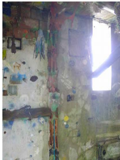
PILAstra DE LADRILLO ABERTA DE ARRIBA A ABAIXO
