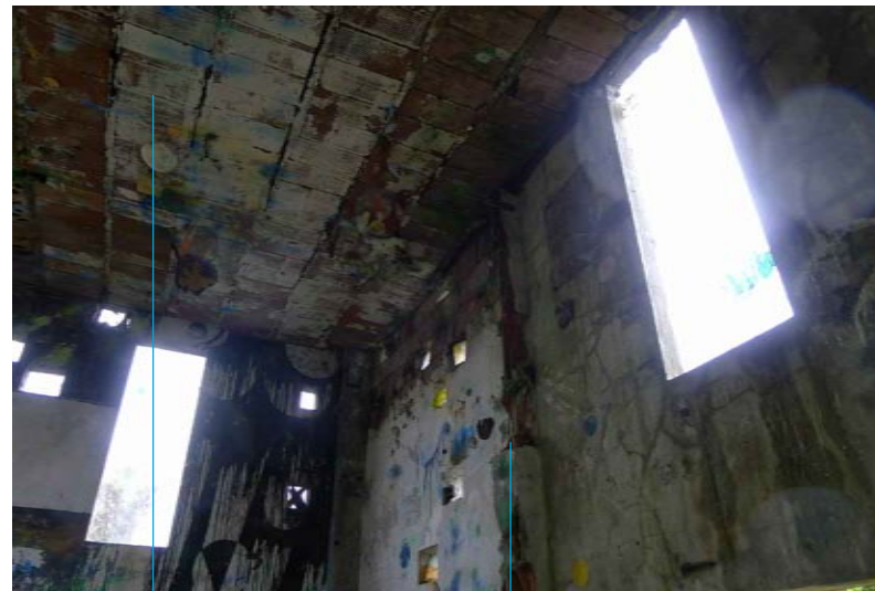
PILASTRA DE LADRILLO ABERTA DE ARRIBA A ABAIXO
