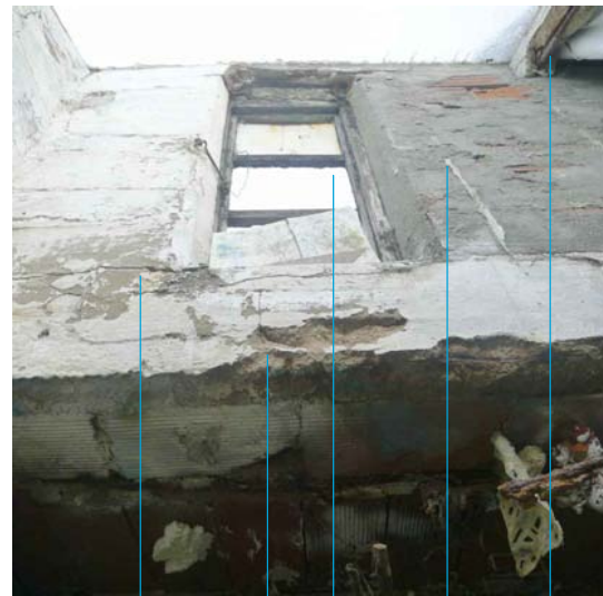
FENDA FALLA DE MATERIAL
